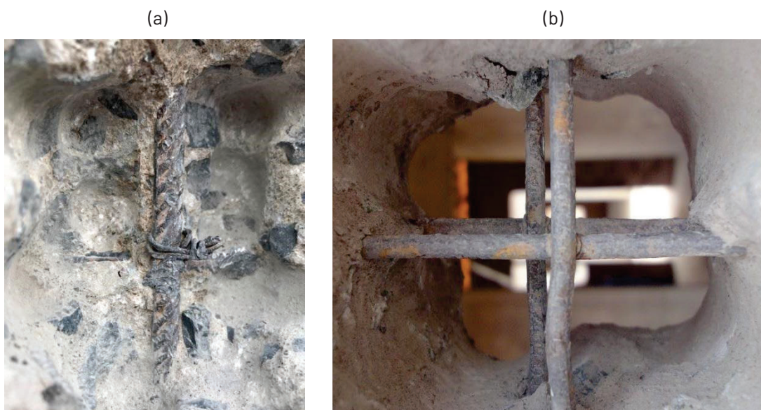
Figura 38 – Exposição de trecho de armadura passivada em áreas recém-fraturadas (a, b). Observam-se pequenas manchas de coloração alaranjada opaca, típicas da concretagem de barras corroídas (b).
